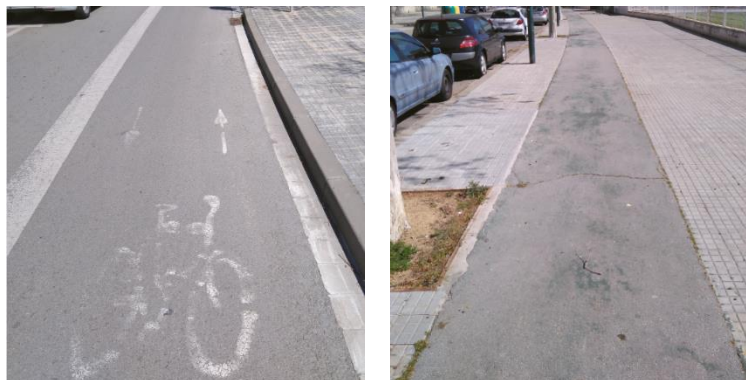
Carrils bici amb senyalització horitzontal desgastada
