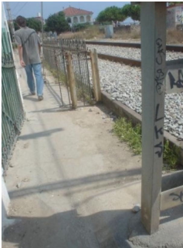
Foto 8. Precarietat del camí paral·lel a les vies al final del passeig Llevant
