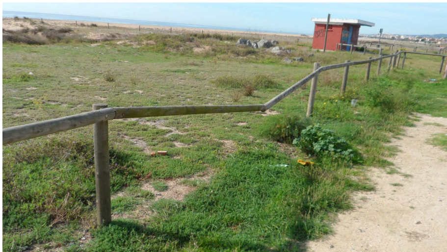
Foto 10. Ran de la carretera de la Pomereda i al TN1, al baranat de fusta li manca un dels puntals
