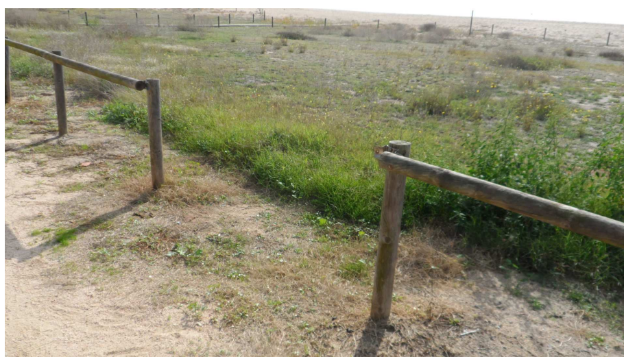
Foto 13. Al sector interior del TN2 (ran de carretera) hi manca un segment del baranat
