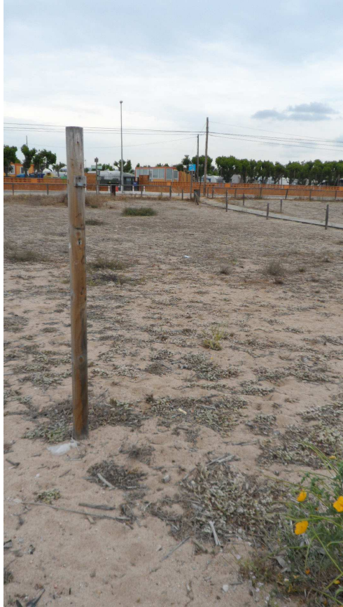
Foto 9. Senyalització vertical sense el panell normatiu a TN2
