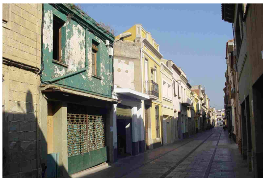
Dos edificis en mal estat al carrer d'en Blanch (a dalt) i Sant Antoni de Pàdua (dreta)
